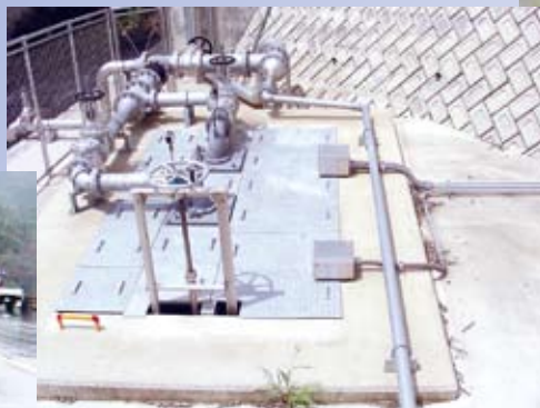
散水槽・散水ポンプ施設
