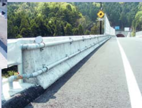
高欄部散水配管
